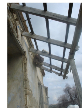
Εικ. 12 Άποψη κατεστραμμένου στεγάστρου μπαλκονιού.
