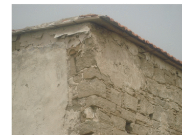
Εικ. 10 Άποψη στέγης. Φθορά επιχρίσματος.
