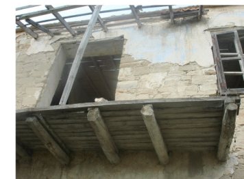
Εικ. 11 Άποψη κατεστραμμένου μπαλκονιού.
