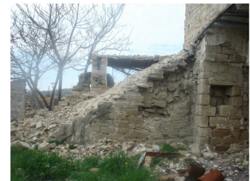
Εικ. 21 Άποψη της κατεστραμμένης σκάλας.
