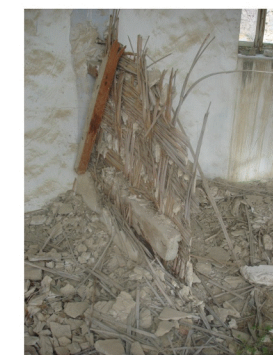
Εικ. 8 Τοιχοποιία από ξύλινα στοιχεία καλάμια και γύφο (κατεστραμμένη).
