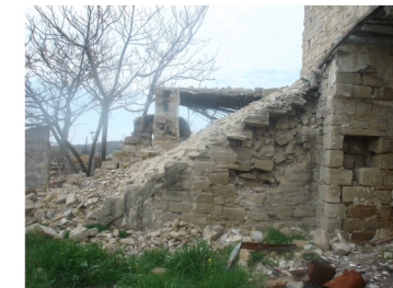
Εικ. 5 Άποψη της κατεστραμμένης σκάλας.
