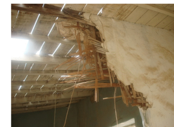
Εικ. 6 Τοιχοποιία από ξύλινα στοιχεία καλάμια και γύφο (κατεστραμμένη).
